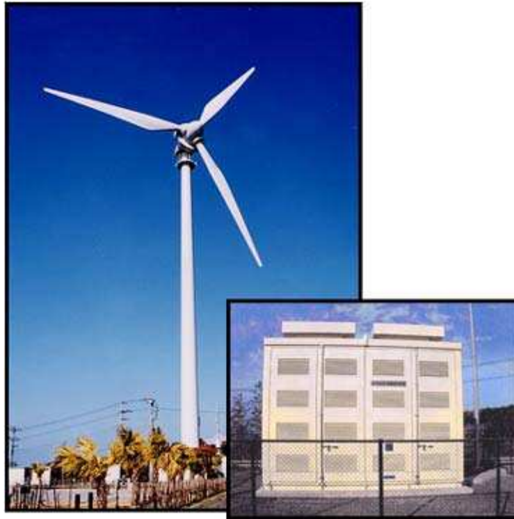
Figure 31 : photos de l'éolienne et de la batterie NaS
