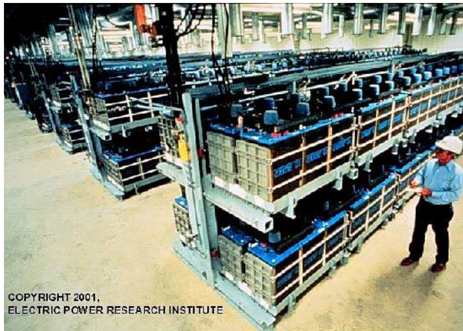
Figure 18 : exemple des stockage à grande échelle à batteries Pb-acide à Chino (Californie). Capacité: 40 MWh–10 MW. Coût: 200Euros/kWh ou 800 Euros/kW
